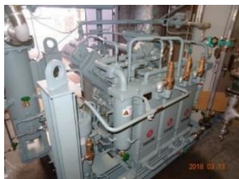
図4 ヘリウムガス回収圧縮機
