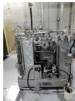
図7 ヘリウムガス回収 圧縮機 ・C5U217GPEX (Burckhardt 社製) ・吐出流量 105 Nm 3 /h ・2014 年新設
