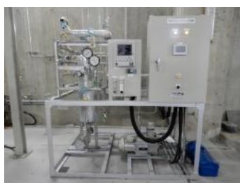
図9 中圧ガスドライヤー ・MARUTANI MD-3 P-25E ・処理能力 125 Nm 3 /h ・1筒式 2020 年更新
