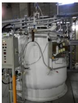
図8 液体ヘリウム貯槽 ・CH-3000 (Wessington 社製) ・容量 3000 L ・2011 年大岡山から移設 (大岡山には 1996 年納入)
