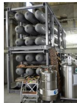
図10 ヘリウムガス用 長尺容器 ・全容量 1260 m 3 ・2014 年新設
